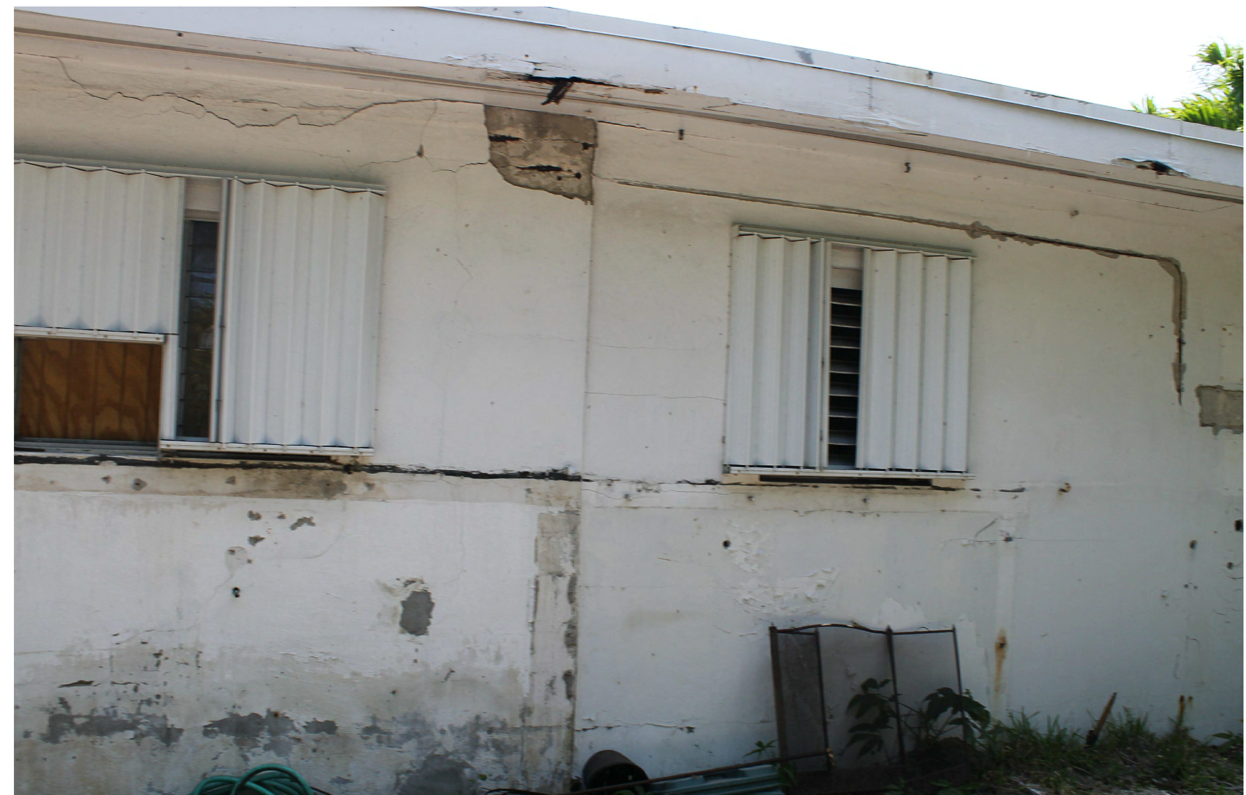
4 EXTERIOR SPALLING SCALE: N.T.S.
