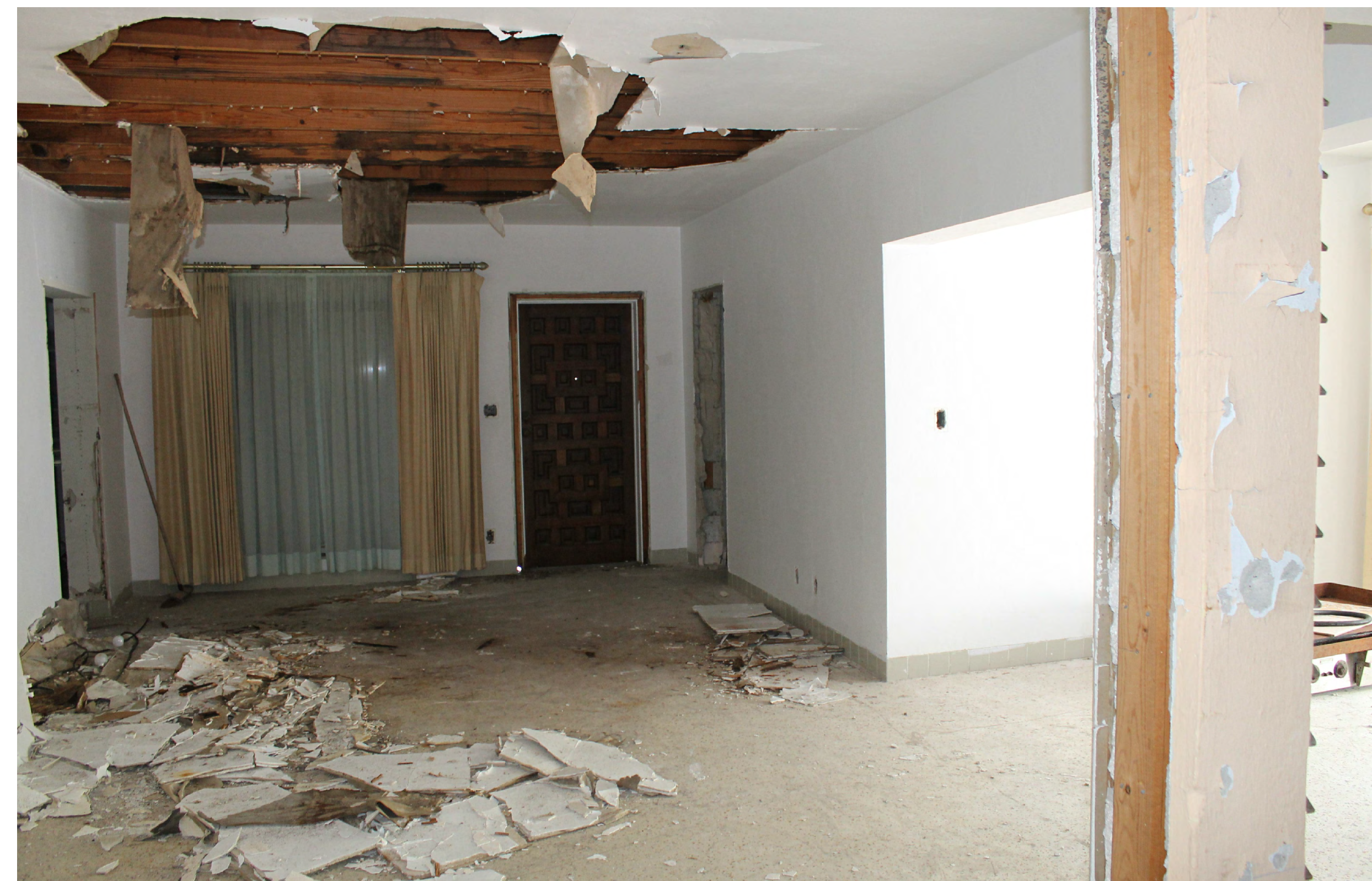
3 INTERIOR WATER DAMAGE SCALE: N.T.S.
