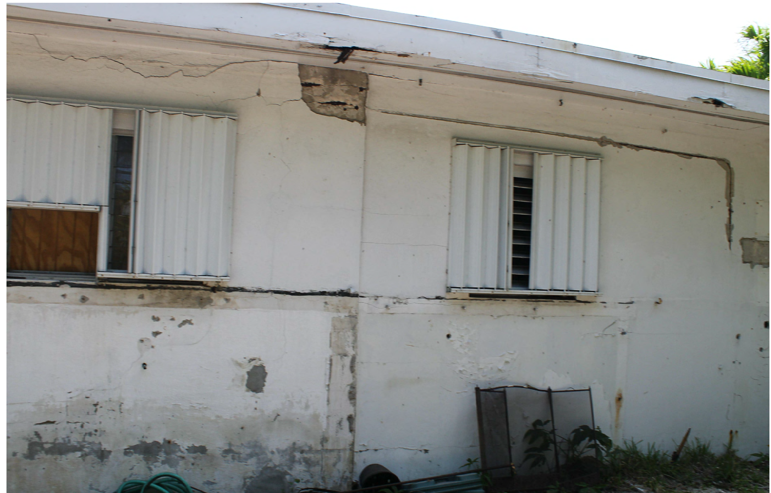
4 EXTERIOR SPALLING SCALE: N.T.S.
