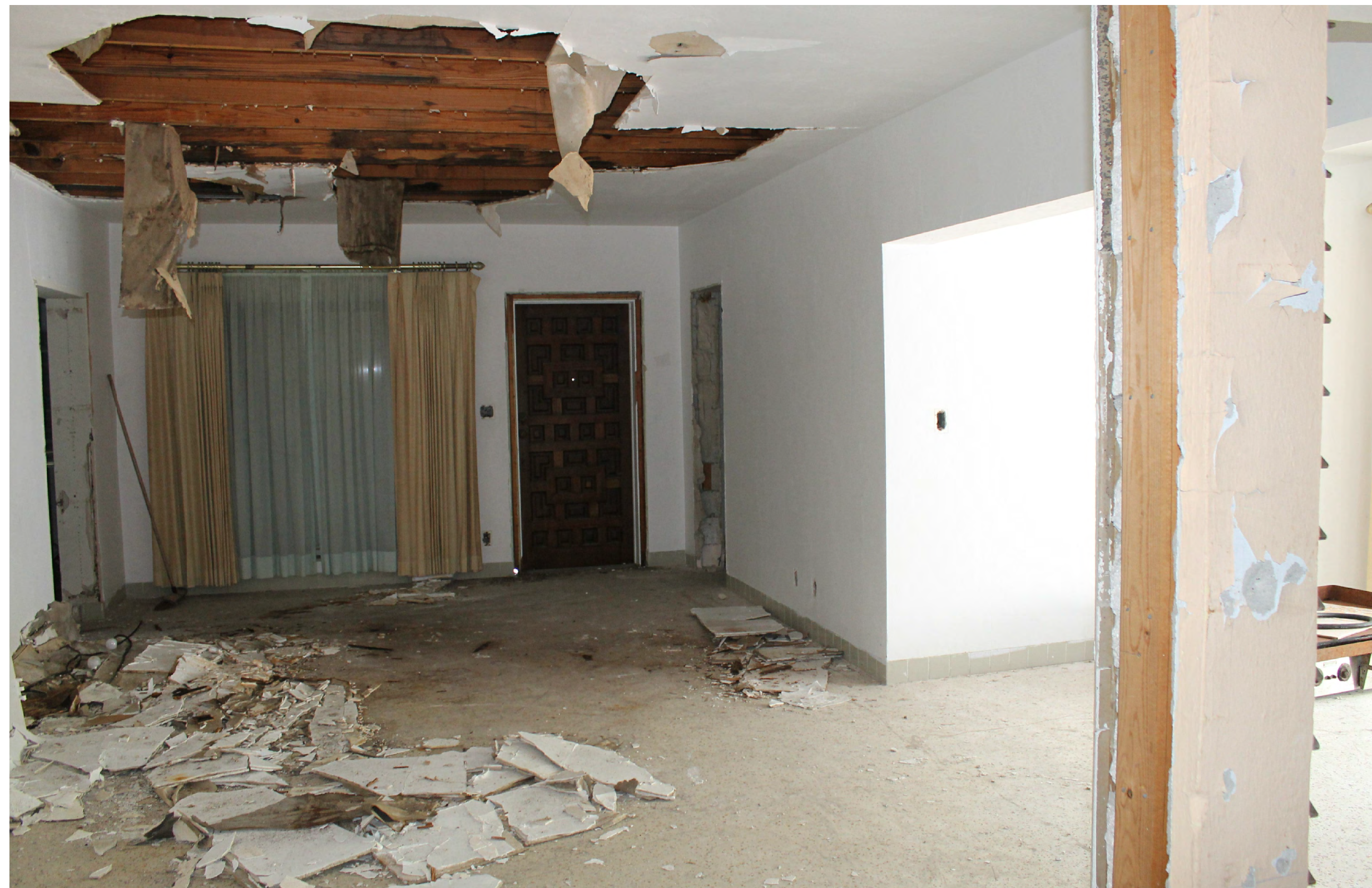
3 INTERIOR WATER DAMAGE SCALE: N.T.S.
