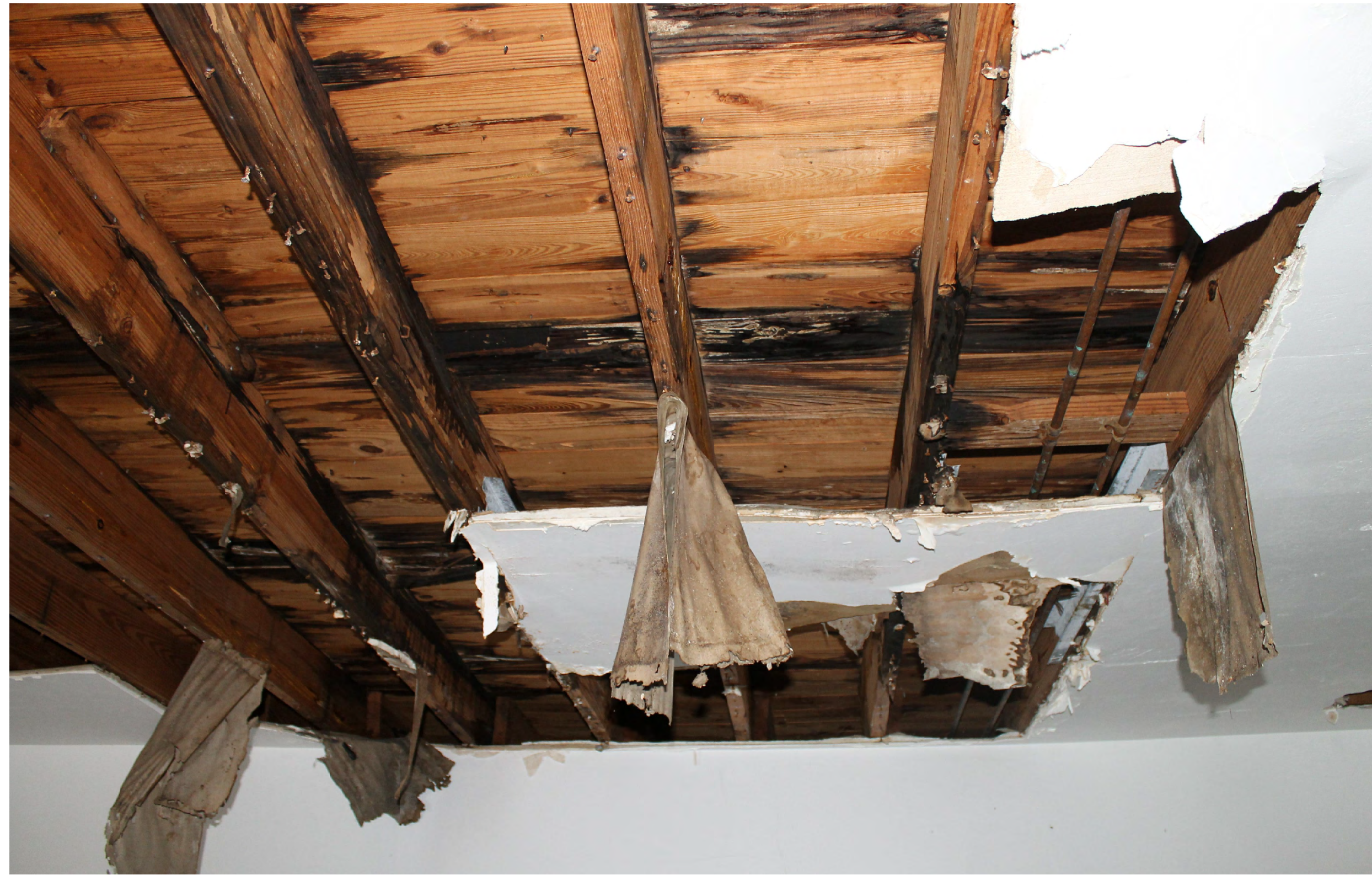
1 INTERIOR WATER DAMAGE SCALE: N.T.S.
