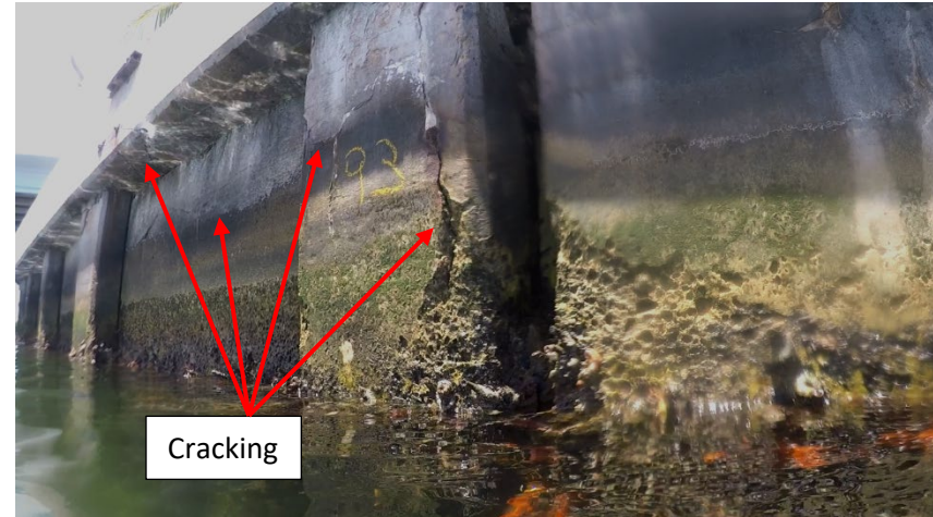
Deficiency B-98/99: Pile 137 & Panel/Cap 137-138 (Station 9+89/9+93)
